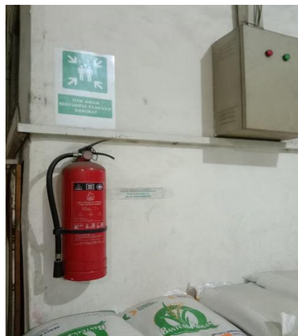
Gambar 6 : Foto alat pemadam kebakaran di PT. Pos Indonesia (Persero) Kantor Cabang Gunungsitoli (Selasa, 30 Januari 2024)
