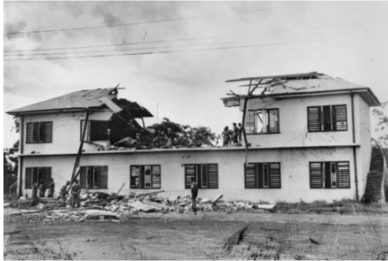
Gambar 2.9 Kerusakan Bangunan Tingkat Berat
