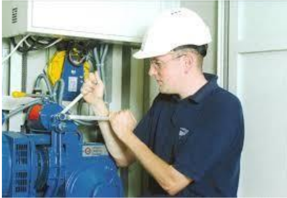
Gambar 2.3 Perawatan Komponen Mekanikal Lift
