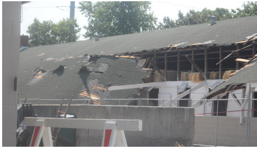
Gambar 2.8 Kerusakan Pada Termasuk Kerusakan Sedang
