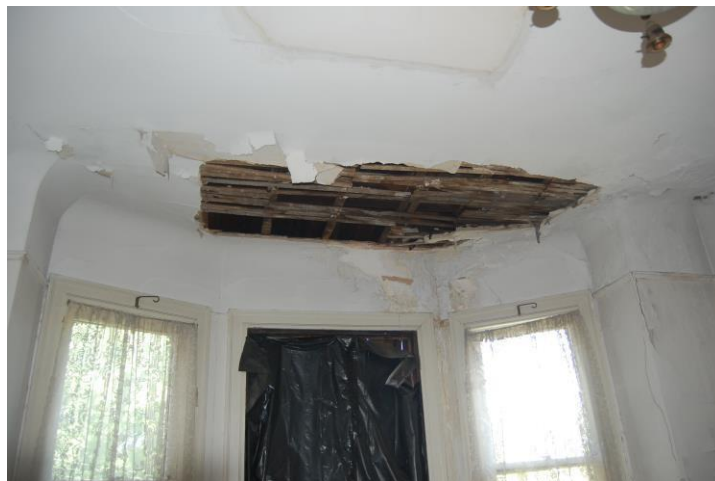
Gambar 2.7 Kerusakan Ceiling/Plafond Pada Bangunan Termasuk Kerusakan Ringan
